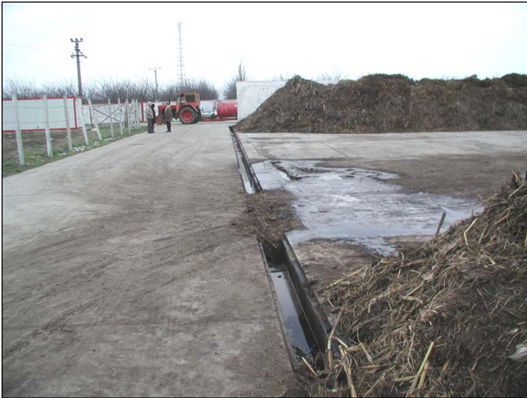
Foto nr. 4: Imagine asupra canalului ce dirijează lichidele către bazinul de retenție
