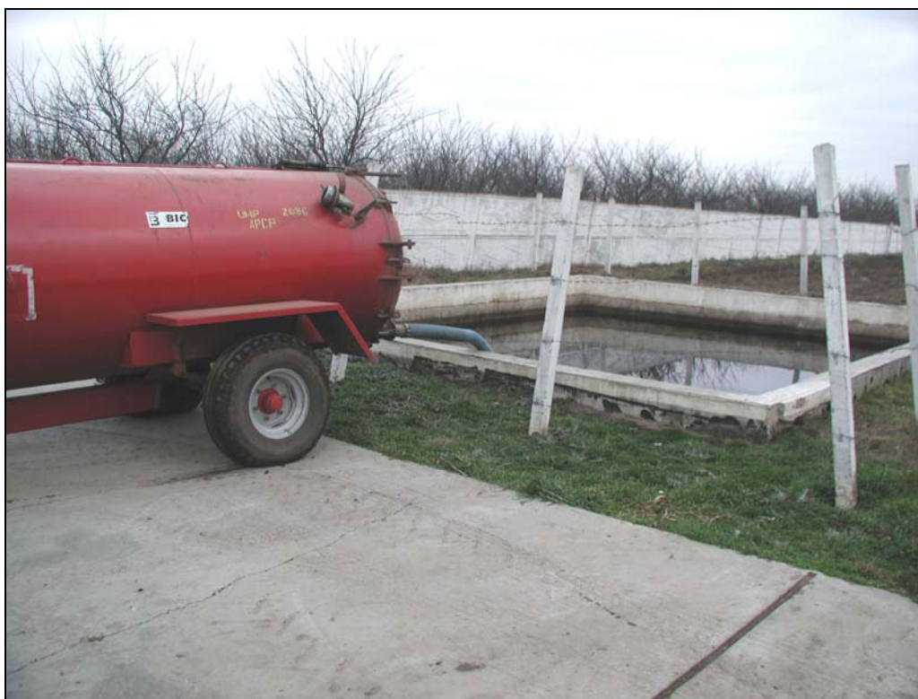
Foto nr. 5: Bazinul de retenție a lichidelor și cisterna pentru golirea acestuia
